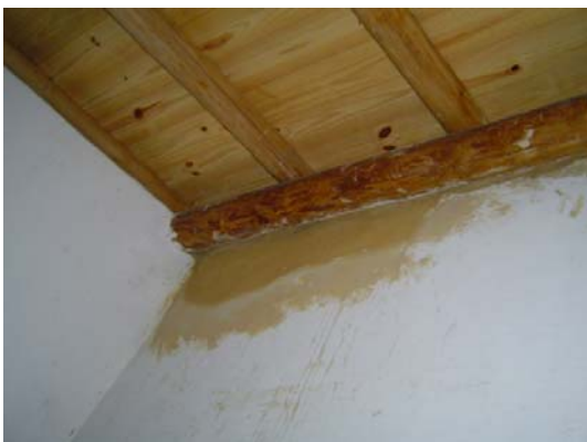
3) falta de acabamento
