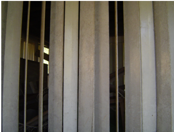
10) brises mal conservados
