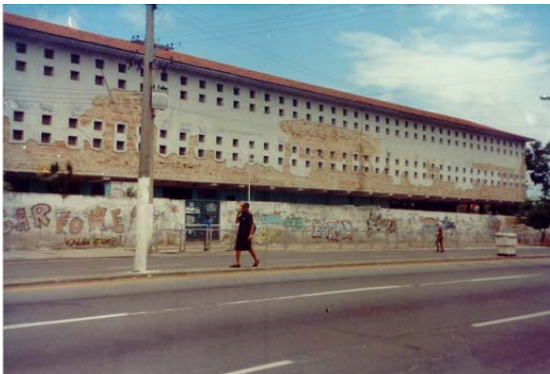
Fig. 4 – Degradação do Colégio – Fonte: Arquivo do Colégio Estadual Raul Vidal ano 2001
